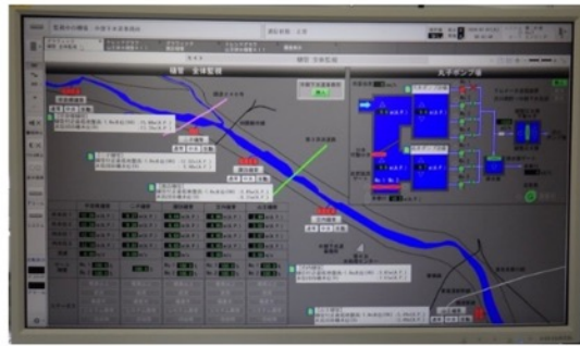
(中央監視装置のモニター画面の写真)
